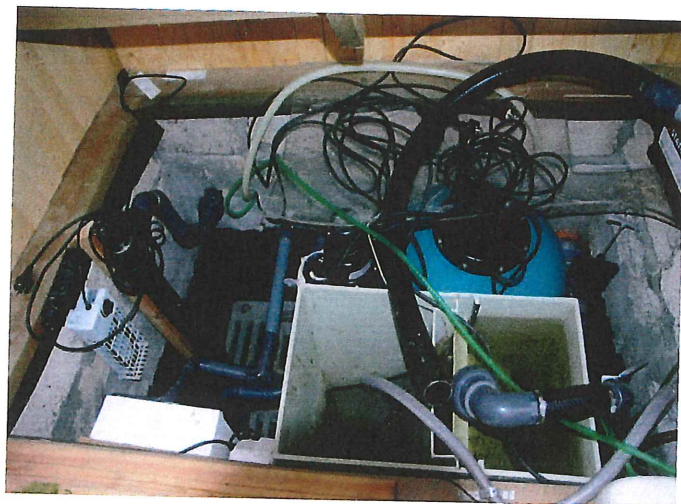
Teknikrummet, Trångt är det.
