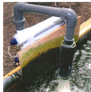
Vattenutlopp med syresättning och UV
